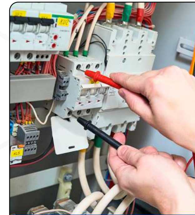
Proyectos Eléctricos: Residencia, Comercial, Industrial.
